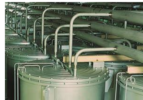
日本原燃HP 遠心分離機 (カスケード)
