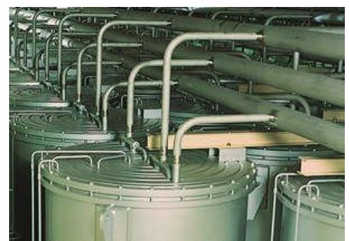
日本原燃HP 離心分離機 (Cascade)
